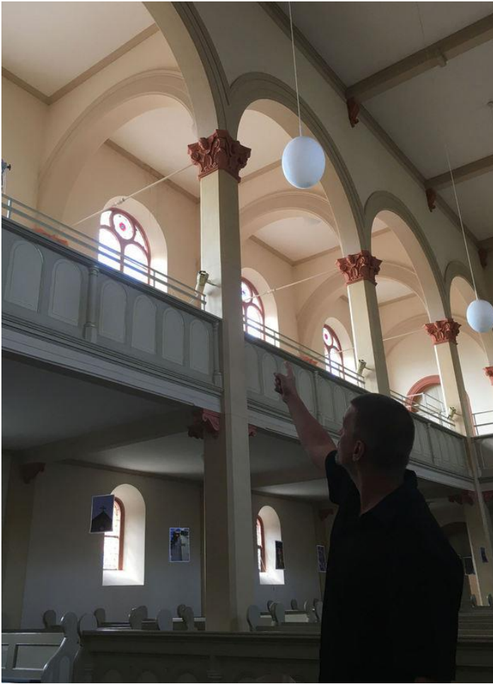
Pfarrer Dierk Rafflewski zeigt, an welchen Stellen wegen des maroden Dachs bereits Wasser eingedrungen ist. © Anja Görlitz
